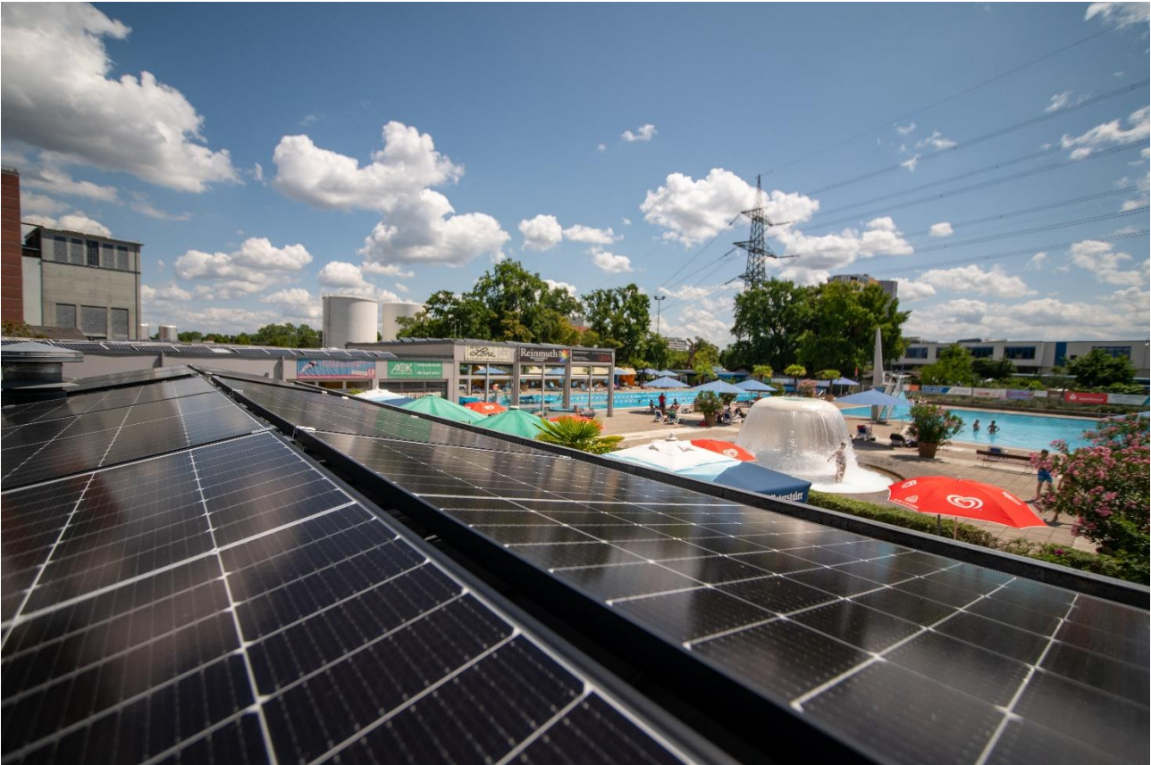
Abbildung 9: Solaranlage Sonnenbad, Stadt Karlsruhe, Boris Burghardt
