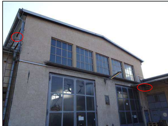
8: An der Rückseite des höheren Nebengebäudes befindet sich links am Fenster viel Vogelkot u. rechts in der Mauerspalte ein Vogelnest, das nicht d. Hausperlingen zugeordnet werden konnte.
