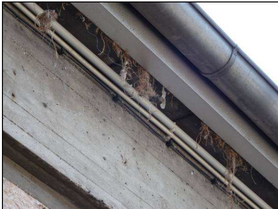
7: Blick auf die Sperlingsnester in der Verblendung auf der Hallennordseite.
